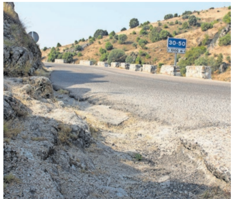
Un bache en un tramo de la red de carreteras gallega. ASOCIACIÓN ESPAÑOLA DE LA CARRETERA
