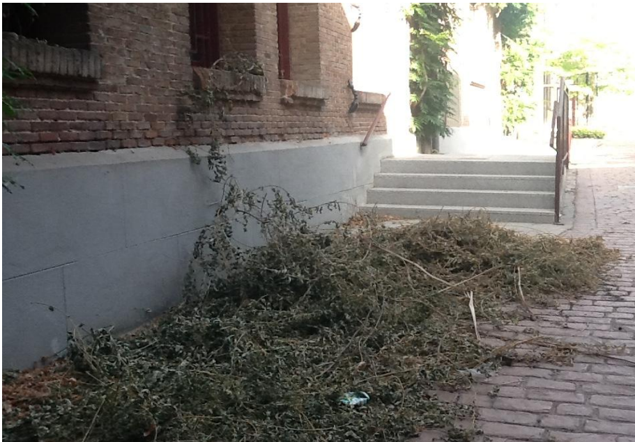
Falta de limpieza en zonas comunes
