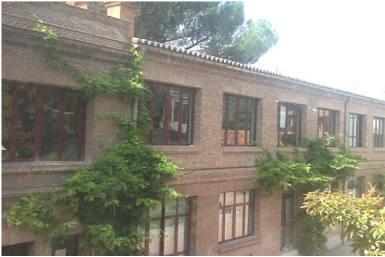
Visualización del peto de cubierta y bajante causantes de las humedades
