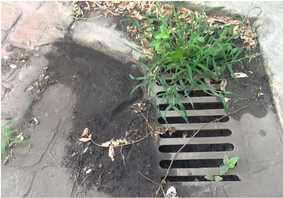
Sumideros atascados por falta de limpieza
