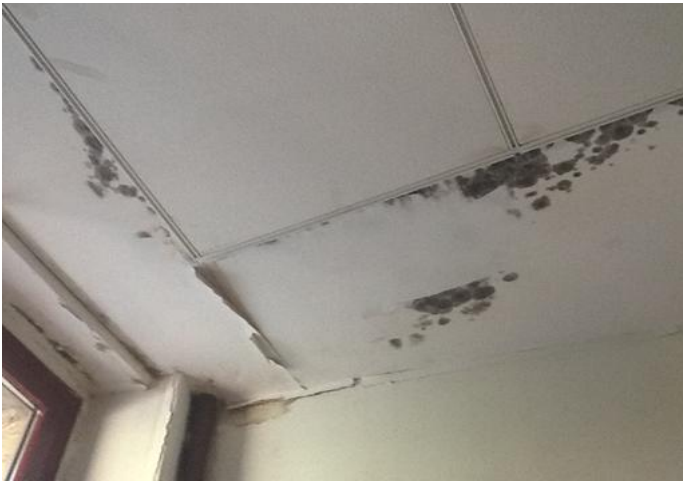
Humedades producidas por la mala evacuación de las aguas pluviales
