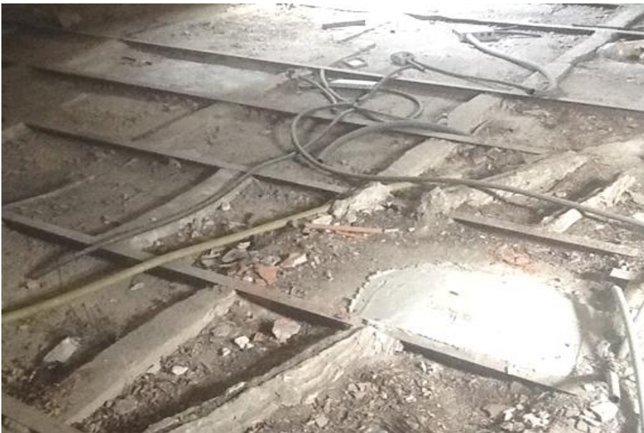
Zona abuhardillada (cubierta), donde se ve el estado de suciedad
