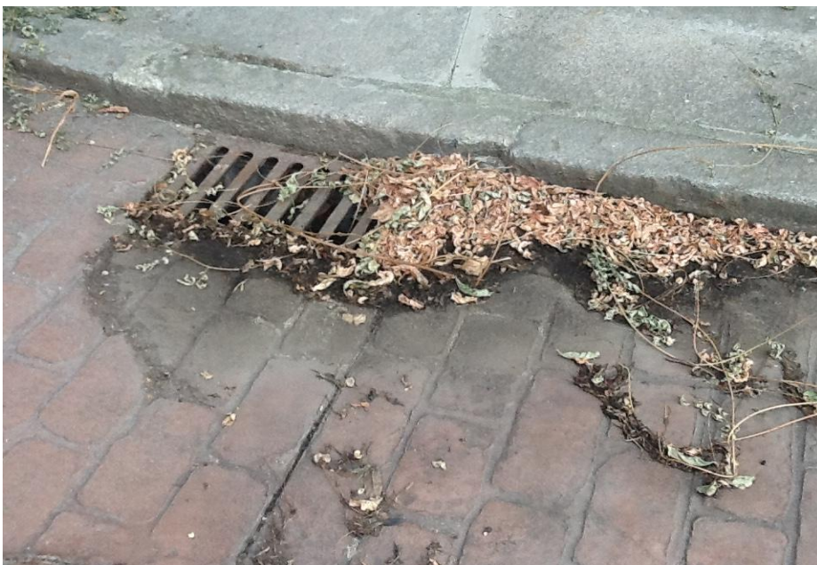
Sumideros atascados por falta de limpieza
